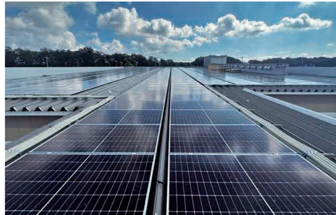
「マルハン入間店」の屋根に設置した太陽光パネル
